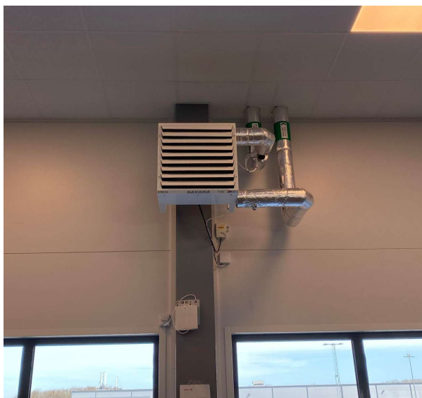
Figur 5.2 Fläktluftsvärmare i Hisingen Logistikpark 2. (Författarnas egen figur)
