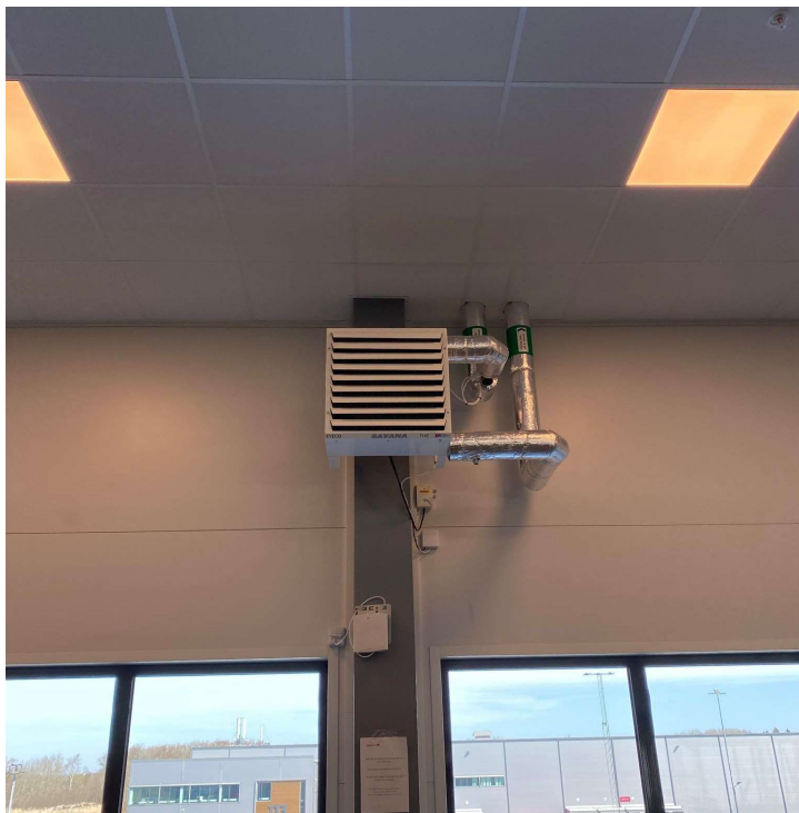
Figur 6.4 Fläktluftsvärmare i gymmet. (Författarnas egen figur)
