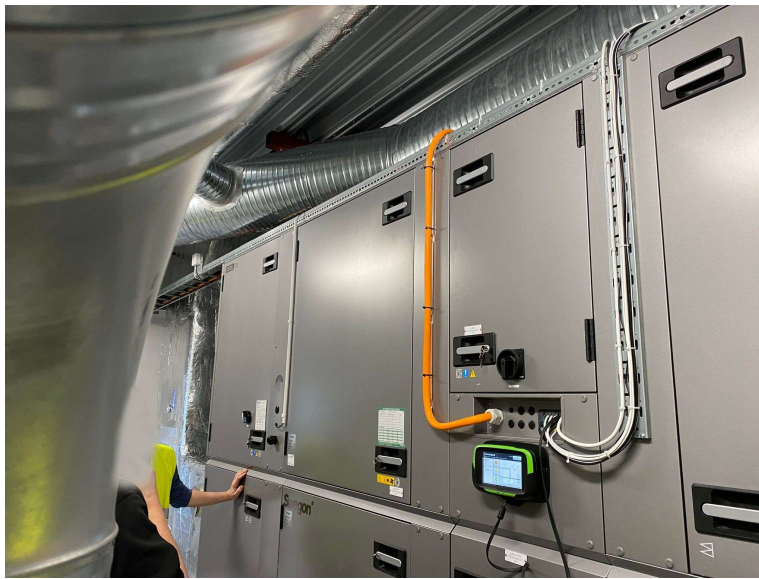
Figur 6.5 Luftbehandlingsaggregat LA01. (Författarnas egen figur)
