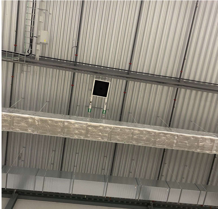
Figur 6.3 Fläktluftsvärmare i lagerytan. (Författarnas egen figur)
