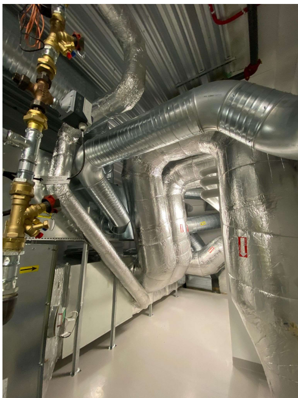
Figur 6.6 Kanaler i fläktrummet för LA01. (Författarnas egen figur)
