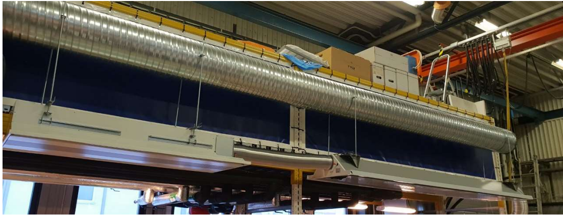
Bild 3.2 Tilluftskanal monterad ovan befintliga kylbafflar.
