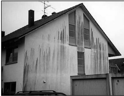
Figur 4.29 Påväxt av rödalger på en putsfasad orsakad av ytkondens. Påväxt sker inte vid köldbryggor och fasadytor som är skyddad mot nattutstrålning (Lenz 2004 2 ).
