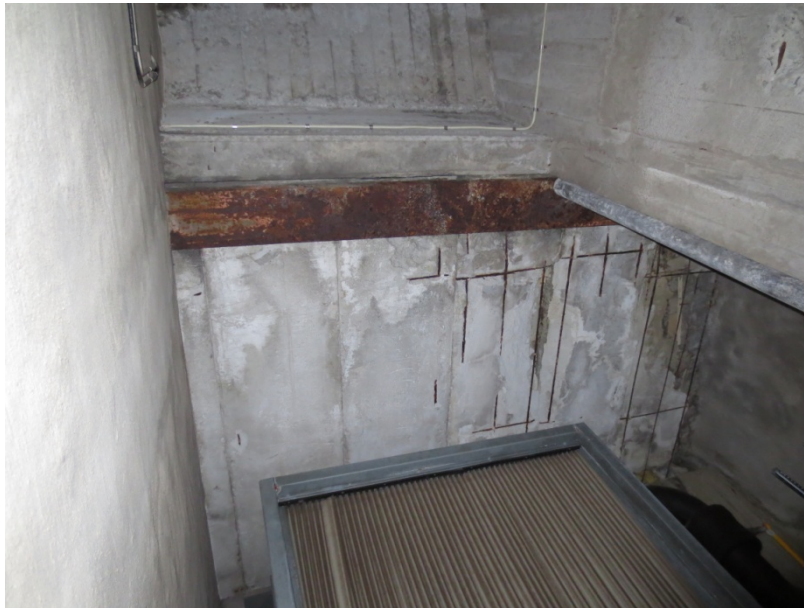
Figur 4.3 Synlig armering i taket. Nederst syns kåpan som täcker kylbatteriet.
