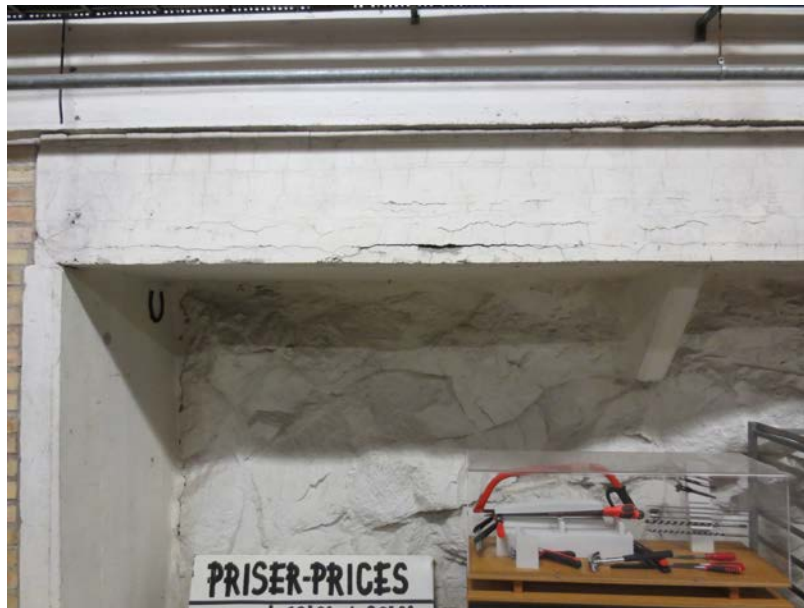
Figur 4.2 Betongbalk där täckande betong spjälkats.
