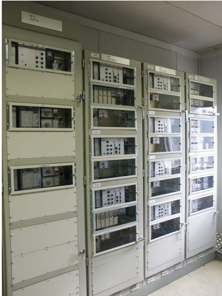
Fig 9. Reläskyddsutrustning i station.
